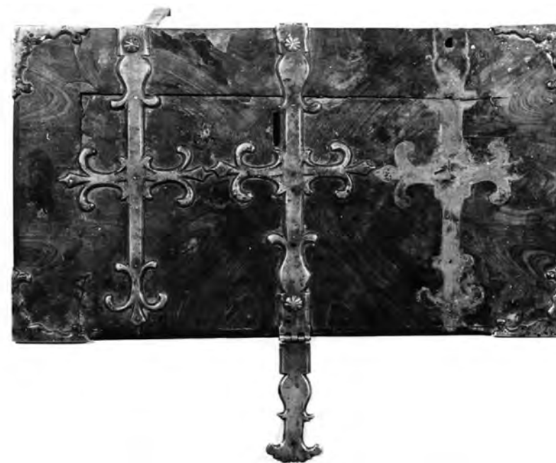
Fot. 4. Wieko skrzynki z widocznym otworem do wrzucania monet, dużym pęknięciem i śladem po brakującym (ale zachowanym) ozdobnym okuciu mosiężnym, przedłużeniu listwy zawiasu
