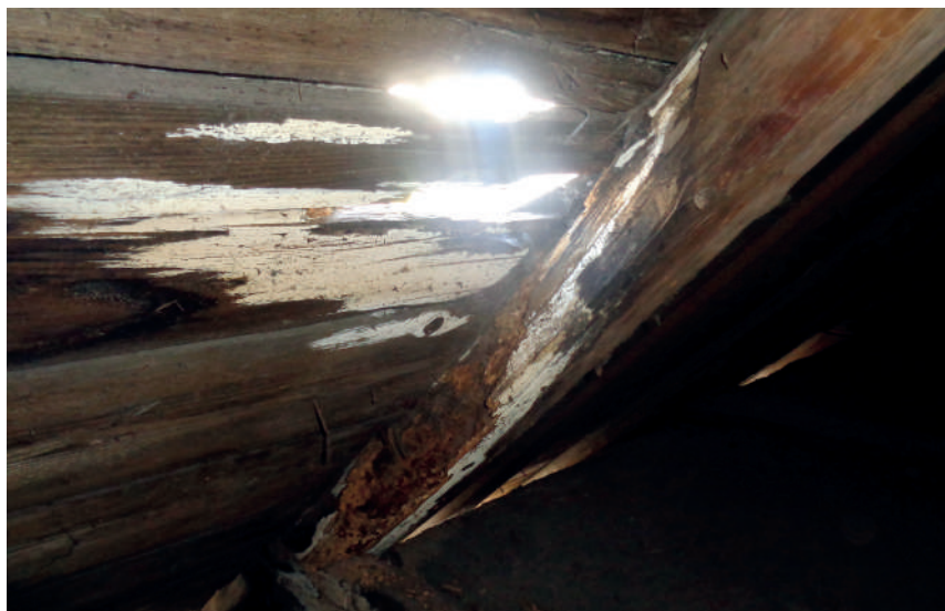
Ryc. 2. Widok nieuszczelnego pokrycia dachu w spichlerzu w Raciborzu-Sudole, 2017 rok
