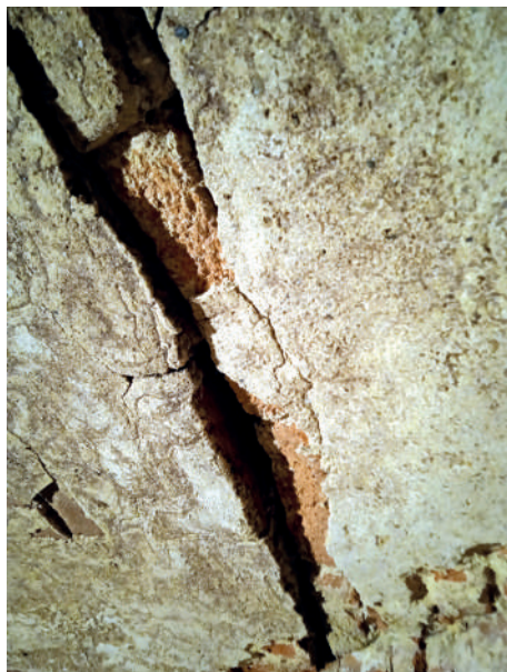
Ryc. 6. Pęknięcie w sklepieniu piwnicy spichlerza w Raciborzu-Sudole, 2022 rok Fot. Cezariusz Magott
